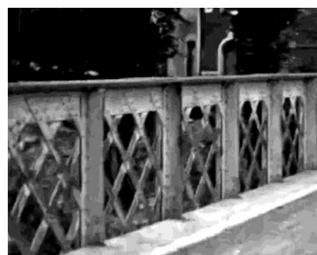
Trottoirs sur le tablier
